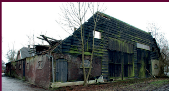
Voor deze vervallen rijksmonumentale schuur te Werkendam is inmiddels een haalbaarheidsonderzoek uitgevoerd gericht op instandhouding
